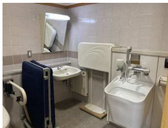
多機能トイレ（道の駅）
