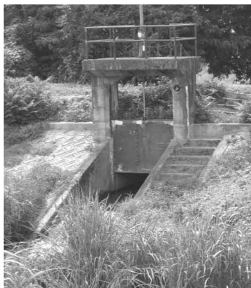
▲主要河川に注ぐ箇所にある排水門
