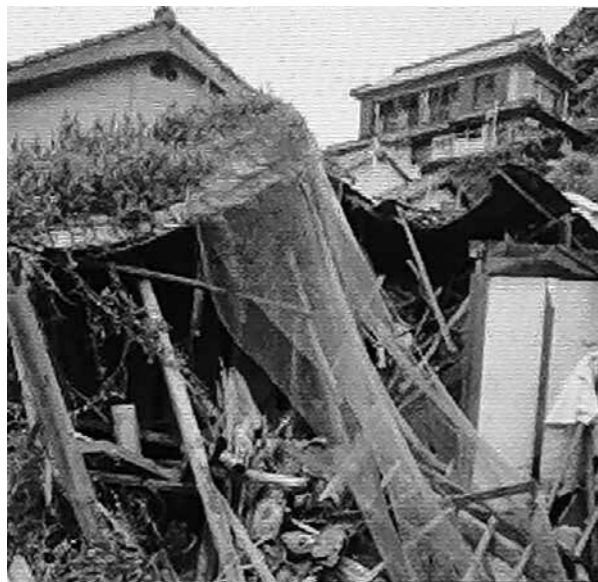
▲危険空き家の例（国土交通省ホームページより）
