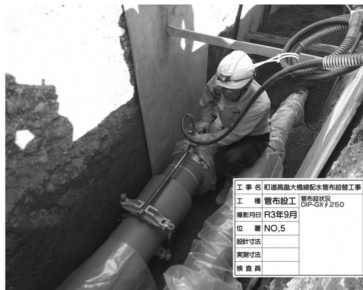
▲計画的に進められている老朽化した排水管の更新工事
