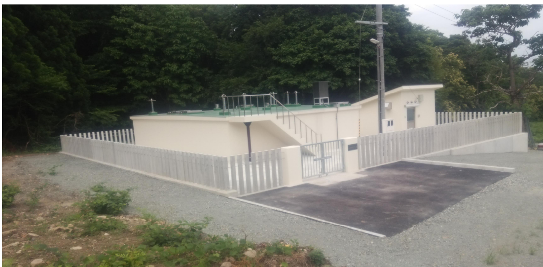
上和田配水池
