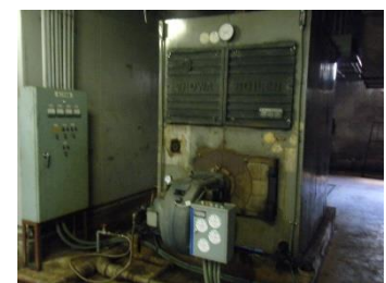
【老朽化した暖房用ボイラー】
