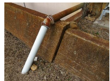
【地盤沈下による亀裂】
