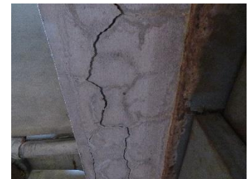
【外壁のひび割れ】
