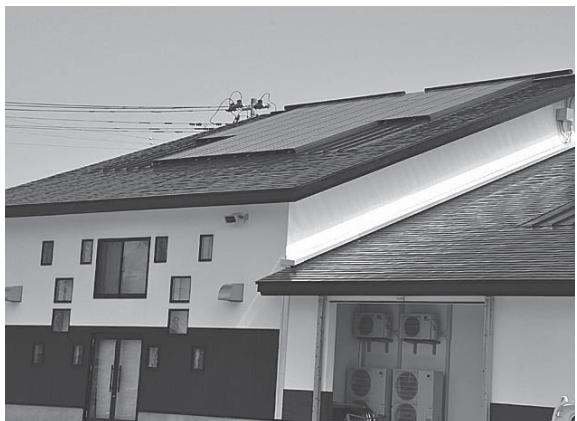
▲屋代地区公民館の太陽光パネル
