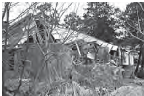
一部倒壊した空き家
