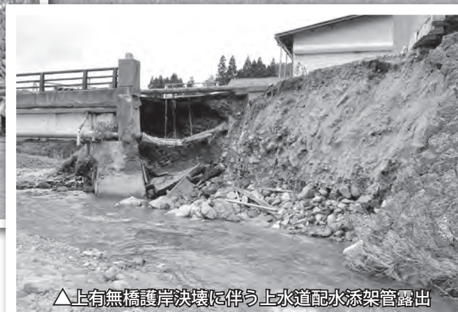
△町道畑中筋線道路および屋代川護岸決壊
