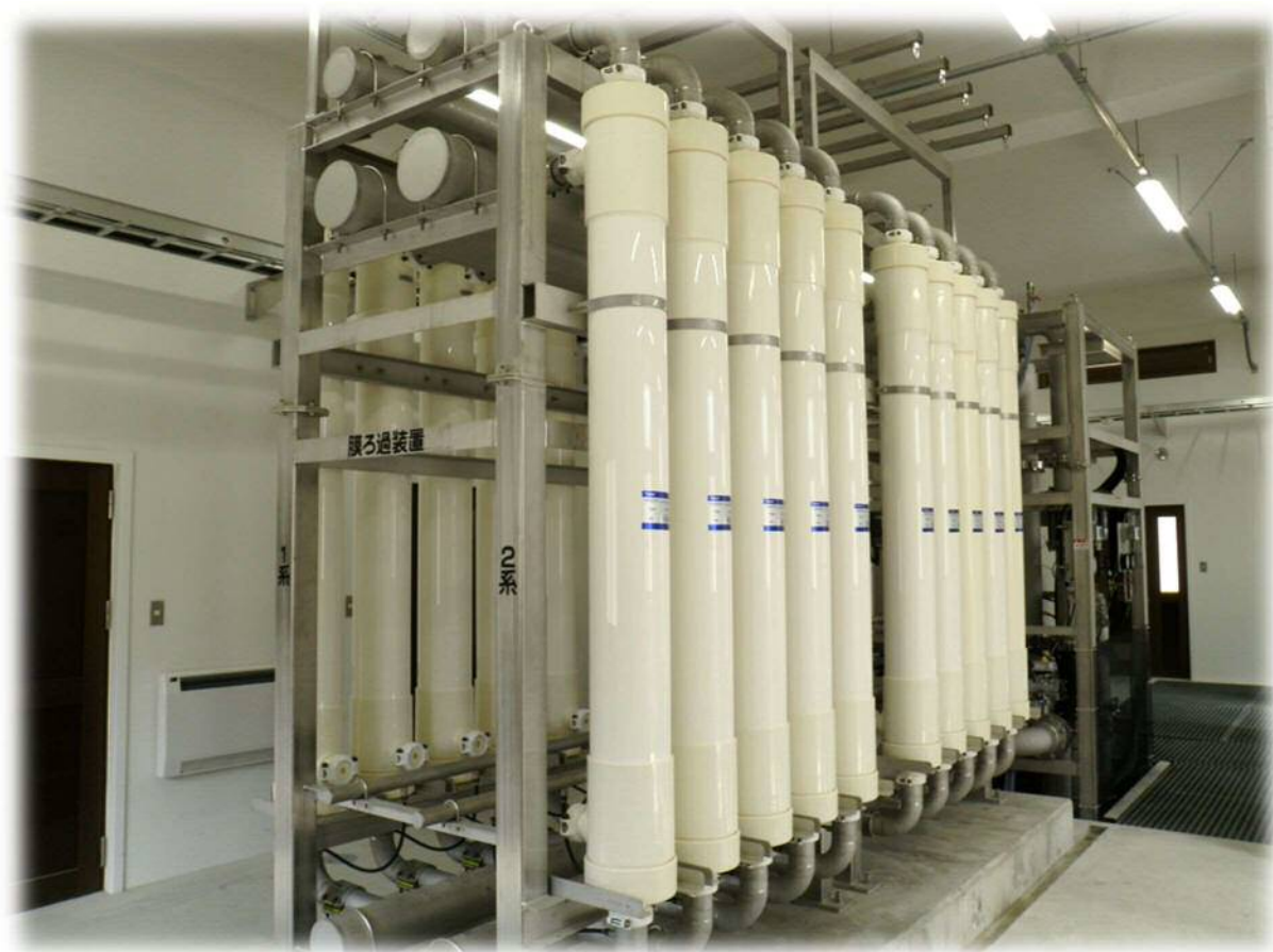
第1水源地 膜ろ過設備
