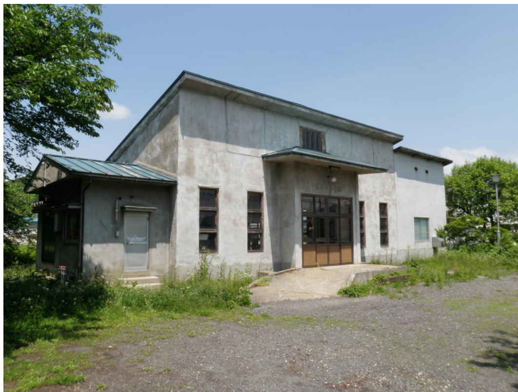
老朽化が進む第2水源地（昭和29年築造）
